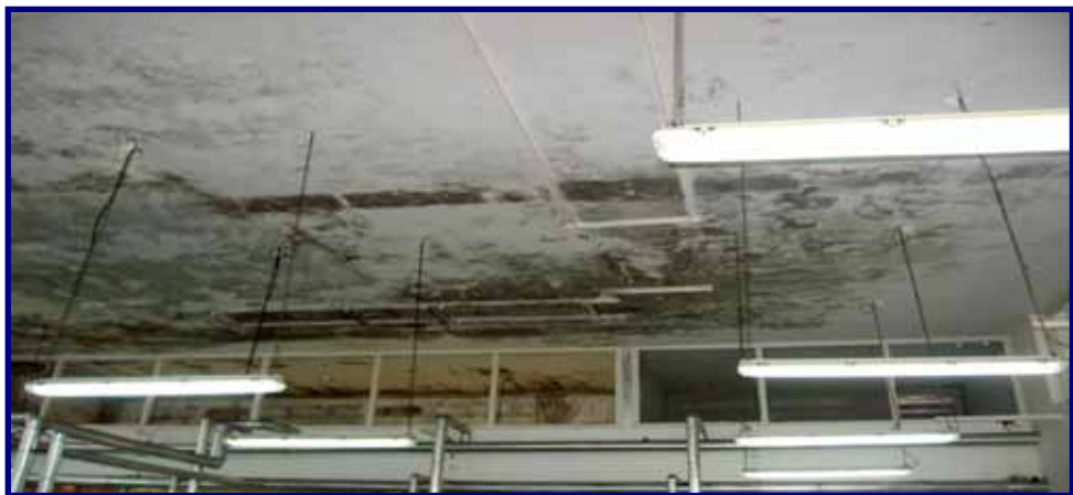
Slika 17. Oštećen strop kao posljedica loše ventilacije.
