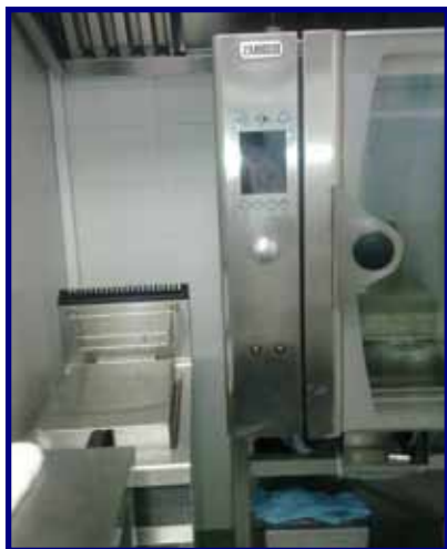
Slika 26. Opremapostavljena preblizo zidu
